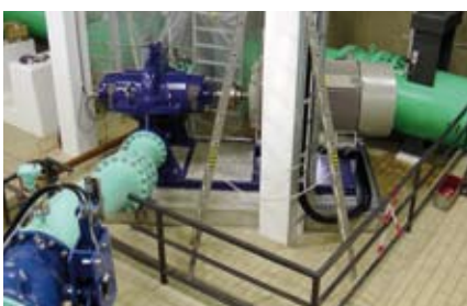
Blick in ein badenova-Wasserwerk.
