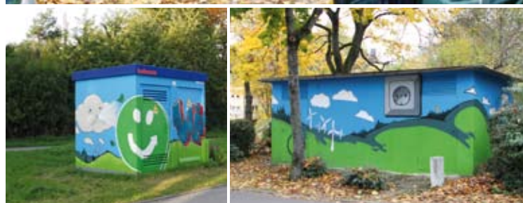
Graffiti-Aktionen an Freiburger Trafostationen.
